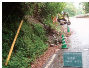
小規模崩落の状況
