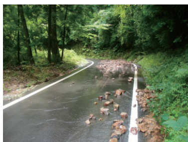
小規模落石の状況
