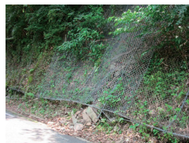
落石防護網裾のこぼれ出し状況
