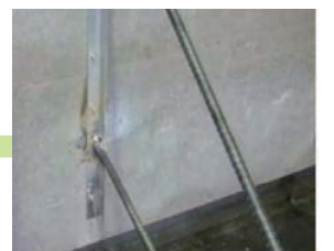
地面と接する最下段は、地面とアングル間は鉄筋かぶり確保する
