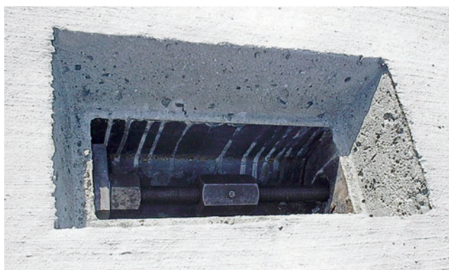
縦締型(連結締め)ジョイントボックス仕様 床版全体をPC鋼棒で連結することにより、荷重の分散効果を計る。
